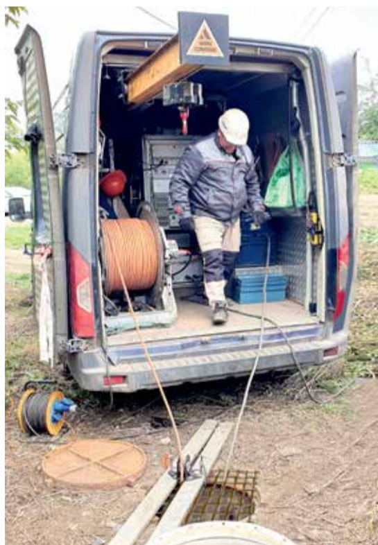
На фото — передвижная лаборатория, специалист подрядной компании «Газпроект-ДКР» и люки колодцев тепловых сетей, куда уже опущено диагностическое оборудование. Место действия — двор за домом № 223 на улице Розы Люксембург в Ново-Ленино
