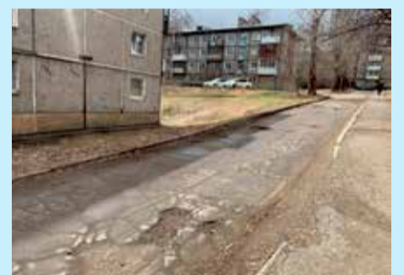
Благодаря работам, которые будут проведены в этом строительном сезоне, такие ямы, как на фото, будут ликвидированы. Ведь в планах депутата Евгения Шеломенцева провести ямочный ремонт, асфальтирование проездов, тротуаров в округе № 25 по нескольким адресам, чтобы жителям было комфортно как проезжать на автомобилях, так и проходить пешком, с колясками
