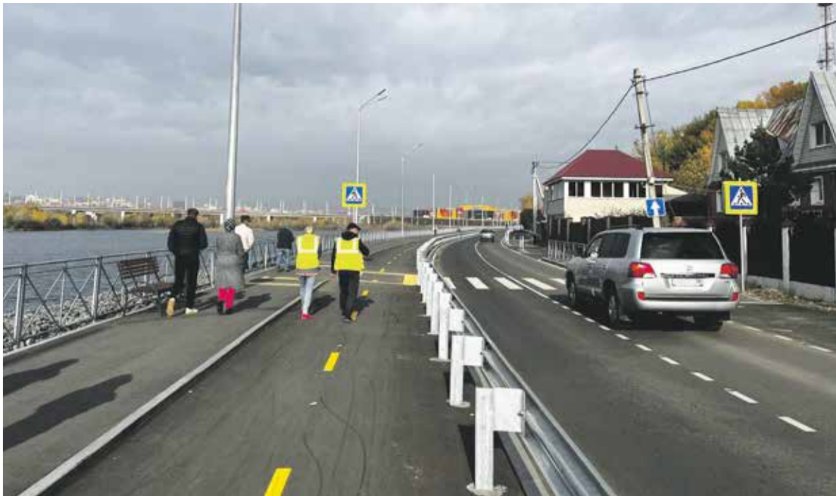
На фото — ремонт участка дороги от Верхней Набережной, 107 до спуска с Академического моста. Окончания работ ждали не только жители избирательного округа № 12, но и все иркутяне. Планируется также провести работы от дома № 107 до бульвара Постышева, проектно-сметная документация — в процессе разработки
