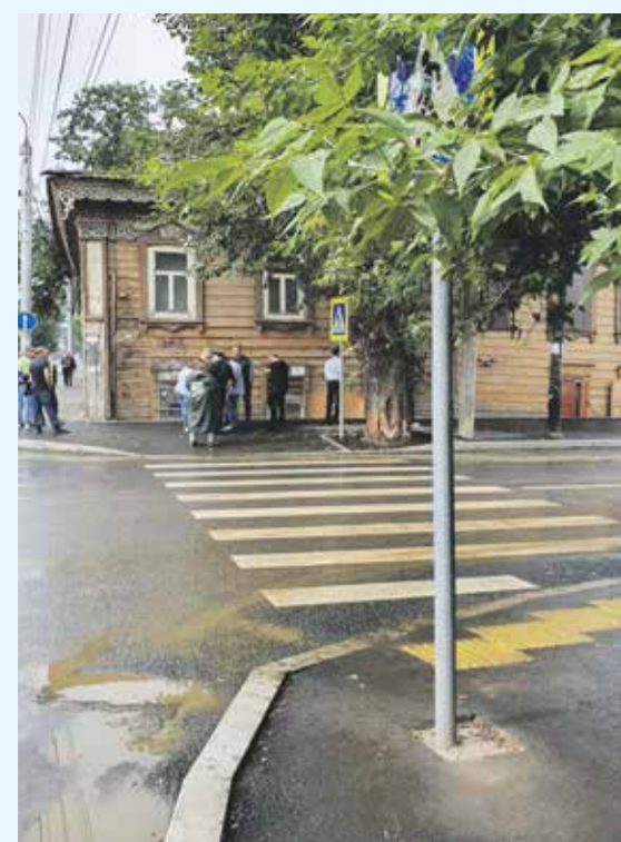
На этом снимке сразу две недоработки подрядчиков — перекрытый листовой дорожный знак и зияющий квадрат на тротуаре под знаком. Ветки — под срез, квадрат — под асфальт, таково предписание комиссии
