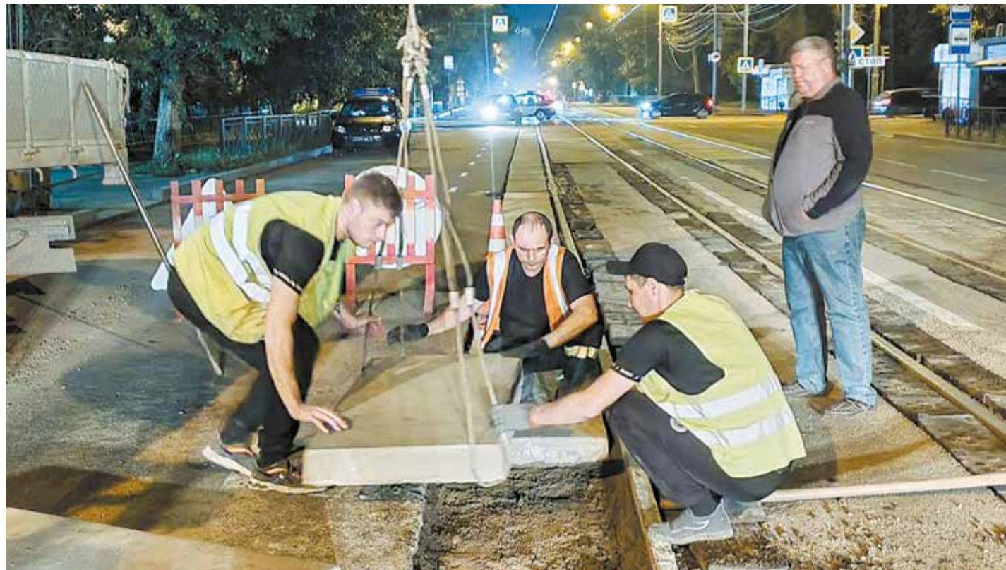
Сначала рабочие «Иркутскавтодора» выравнивают основание отсевом, а затем уже опускают 300-килограммовую бетонную плиту на ее законное место. Специалисты говорят, что такие плиты комфортны для автомобилей и безопасны для трамваев. За одну ночную смену дорожники успевают переделать примерно 15 метров полотна
