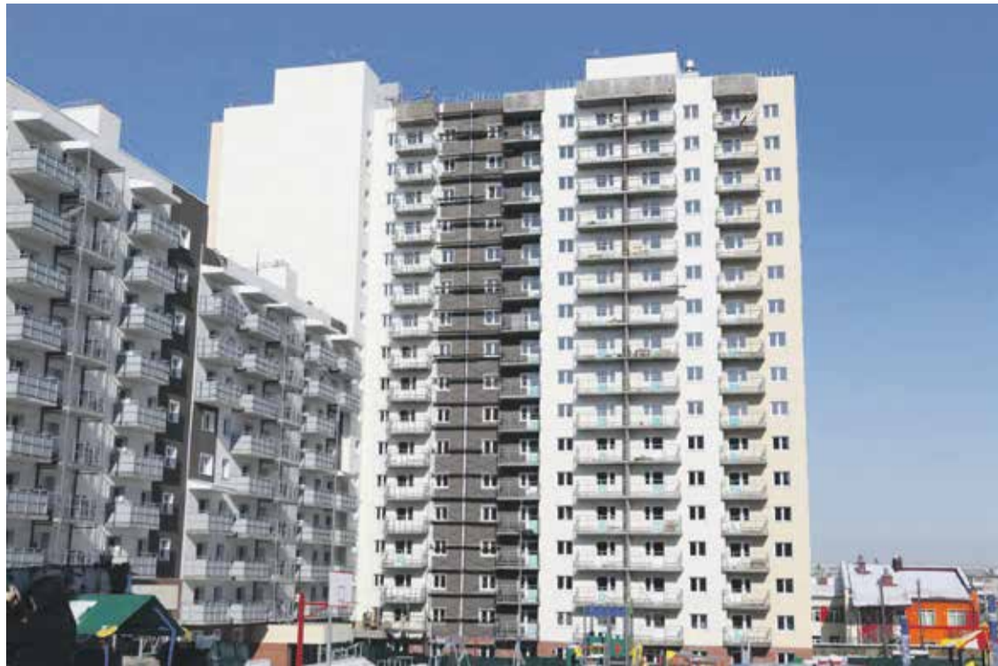
Эти две 17-этажные строящиеся блок-секции в микрорайоне Ново-Ленино (жилой комплекс «Эволюция») близки к завершению: строители ведут внутренние и отделочные работы. Рядом — новые современные детские сады и школа. В новые квартиры с чистой отделкой скоро переедут 187 иркутских семей. Все они — участники региональной адресной программы по переселению граждан из аварийного жилищного фонда
