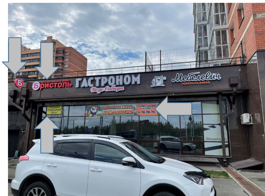
Перечень информационных конструкций, подлежащих демонтажу в добровольном порядке
