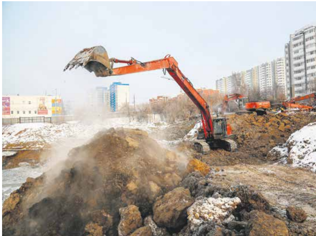
Вот так сейчас выглядит стройплощадка новой школы на улице Багратиона в микрорайоне Юбилейном — идет выемка грунта под котлован. По словам заместителя мэра Евгения Харитонов, городская власть понимает, что стройка в непосредственной близости от жилых домов создает неудобство местным жителям. «Но и мы просим понимания: ведется строительство социального объекта — долгожданной современной школы для этого района», — говорит Евгений Аркадьевич
