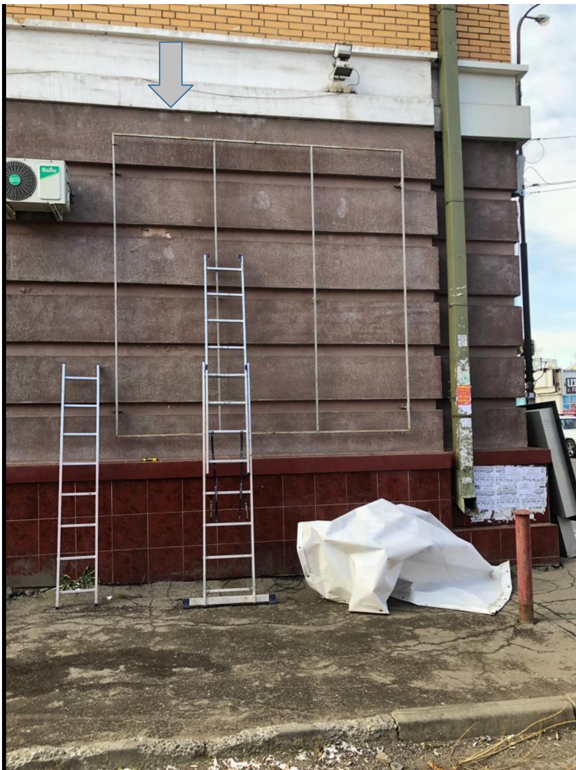
Металлическая конструкция, подлежащая демонтажу в добровольном порядке
