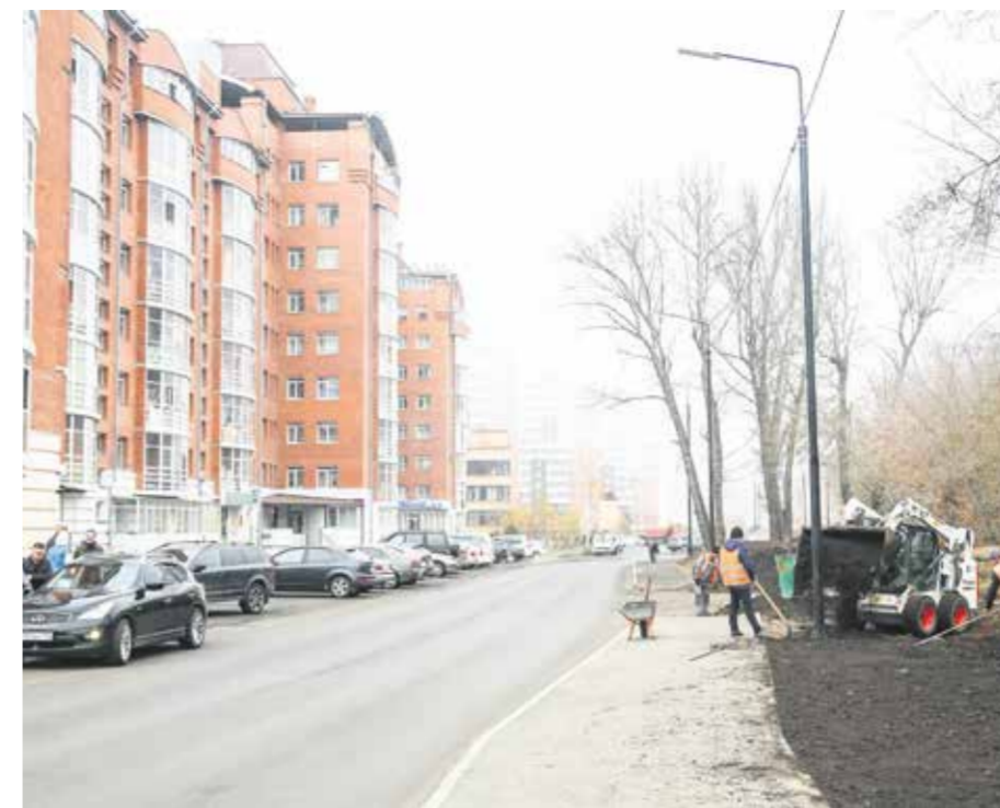
После ремонта на улице Дальневосточной существенно повысилась безопасность дорожного движения: профиль дороги был спроектирован таким образом, чтобы водители не смогли набрать высокую скорость. Вдоль проезжей части появились широкие тротуары. Отдельно можно отметить установку ярких светодиодных фонарей на столбах черного цвета. Это современное решение, которое уже широко используется в крупных городах
