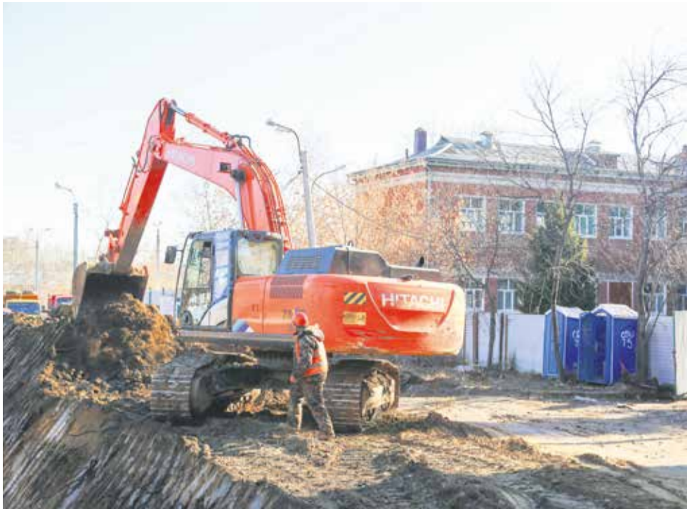
Новый блок школы № 75 строят в непосредственной близости от основного здания, поэтому для безопасности учеников стройплощадку пришлось обнести надежным высоким забором
