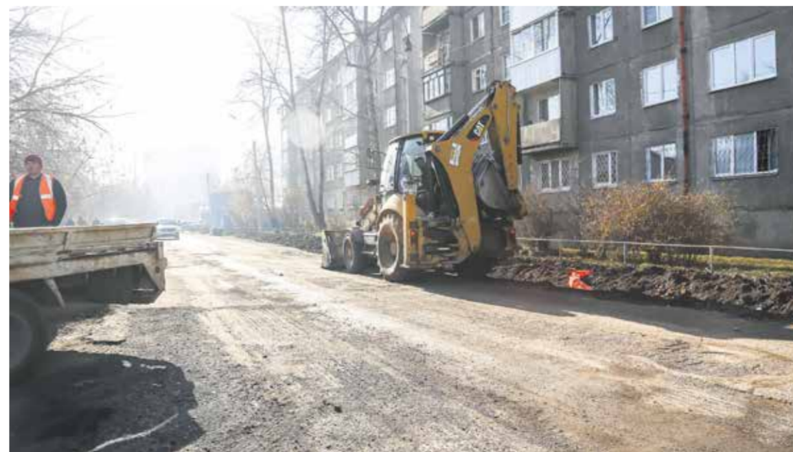
Ремонт дороги на улице Зимней еще идет, хотя должен быть на финишной прямой. Подрядная организация — «Союзстрой» — сорвала сроки выполнения работ, и ей грозят серьезные штрафные санкции
