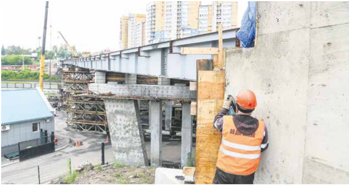
На снимке фоторепортера «Иркутска» Валентина Карпова видно, что основные работы на реконструкции путепровода на Джамбула ведутся внизу, а не на проезжей части. В этом и есть ответ на вопрос горожан «Почему не видно рабочих, есть ощущение, что ничего не делается?» Это не так. Часть бригад работает в нижней части моста, часть — в палатке, где идут сварочные работы по торцеванию швов
