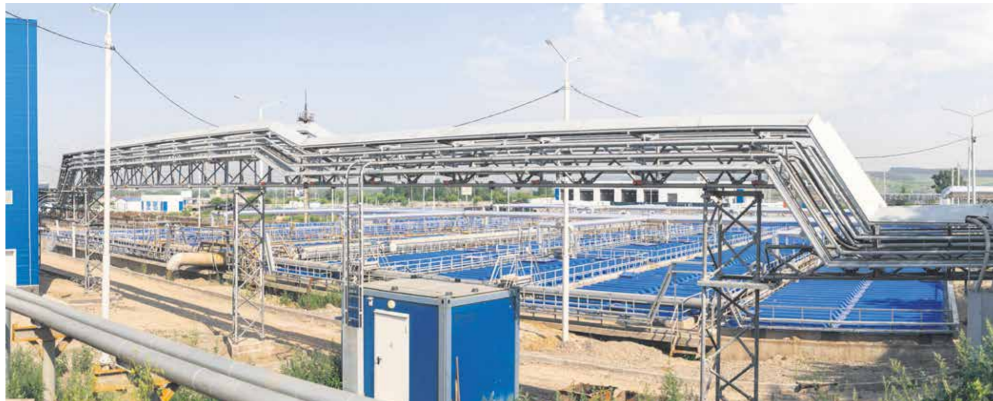
Новые аэротенки очистных сооружений правого берега закрыты пластиковыми настилами, запах здесь практически не ощущается. А к 2023 году его не будет совсем!
