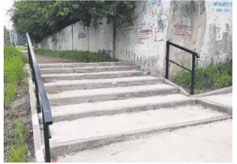
22 (!) лестницы на бульваре Рябикова и на улице Маршала Конева отремонтировали в этом году по инициативе депутата думы Иркутска Григория Вакуленко. На многих установили поручни для удобства жителей
