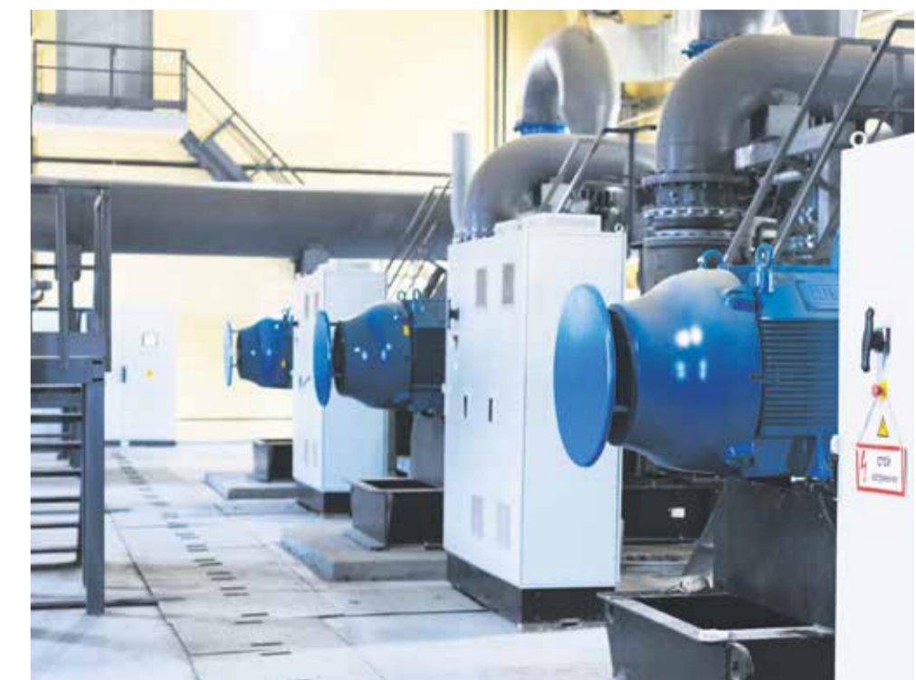
Это установки для подачи воздуха на аэротенки. Воду необходимо постоянно насыщать кислородом для повышения активности микроорганизмов, которые «переваривают» вредные соединения
