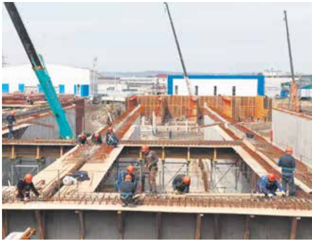
Так выглядит «заготовка» будущего аэротенка на канализационно-очистных сооружениях правого берега. В этих бассейнах специальные бактерии будут очищать сточные воды. Биохимическая реакция будет протекать под крышкой, а запах ликвидируют трубы-газопоглотители
