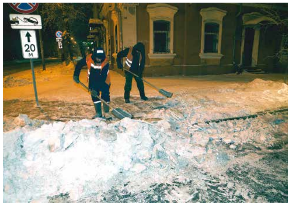
За чистоту тротуаров тоже отвечает Автодор. Процесс уборки достаточно сложный: сначала снег долбят, затем осколки собирают в кучу. После этого снежные «отходы» погрузчик закидывает в кузов КамАЗа
