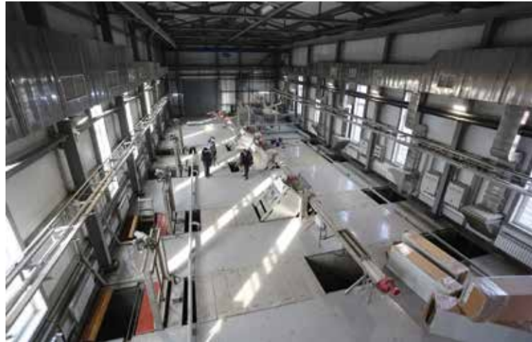
На канализационных очистных сооружениях правого берега с 2015 года идет большая реконструкция. Новое современное оборудование позволит очищать стоки в 4-5 раз эффективнее
