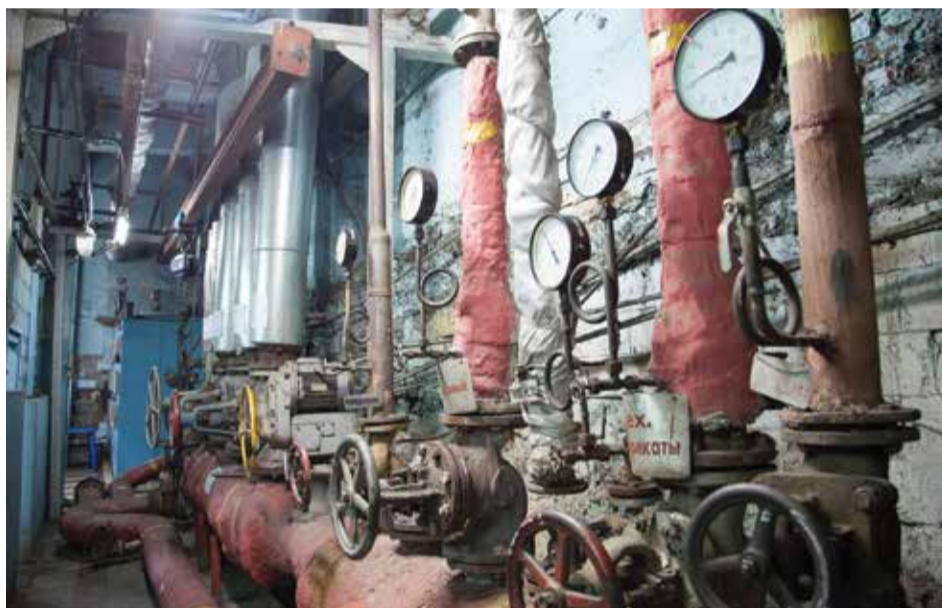
Котельная мясокомбината «Иркутский» — это серьезное большое предприятие, которое при грамотном использовании могло бы отапливать весь район
