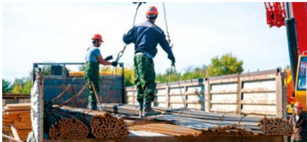
Рабочие приступили к строительству без раскочки, чтобы уже следующей осенью дети пошли в новые детские сады
