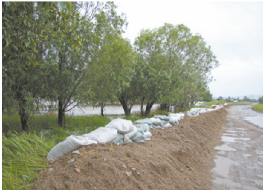
В Свердловском и Ленинском районах укрепили существующие дамбы и установили дополнительные защитные сооружения
