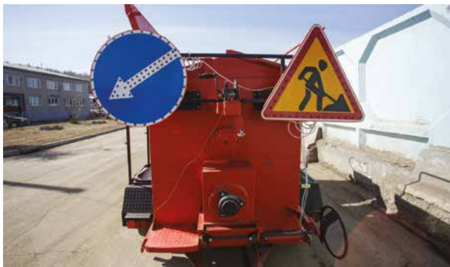
Поступившее в распоряжение Автодора оборудование позволит иркутским дорожникам более качественно выполнять ямочный ремонт
