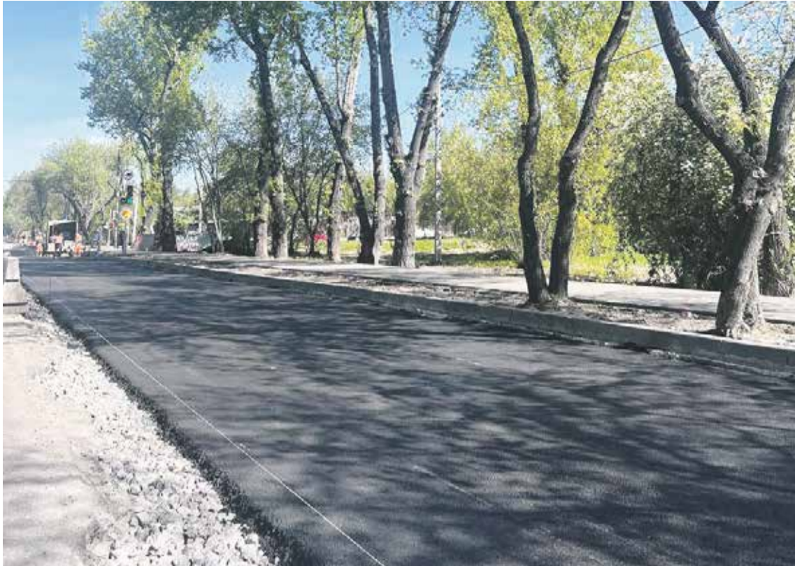
На снимке — новый асфальт укладывают прямо сейчас на улице Розы Люксембург (избирательный округ № 2, депутат Виталий Матвийчук). Это важный участок дорожной сети Иркутска в Ленинском округе, и жители с нетерпением ждут завершения работ
