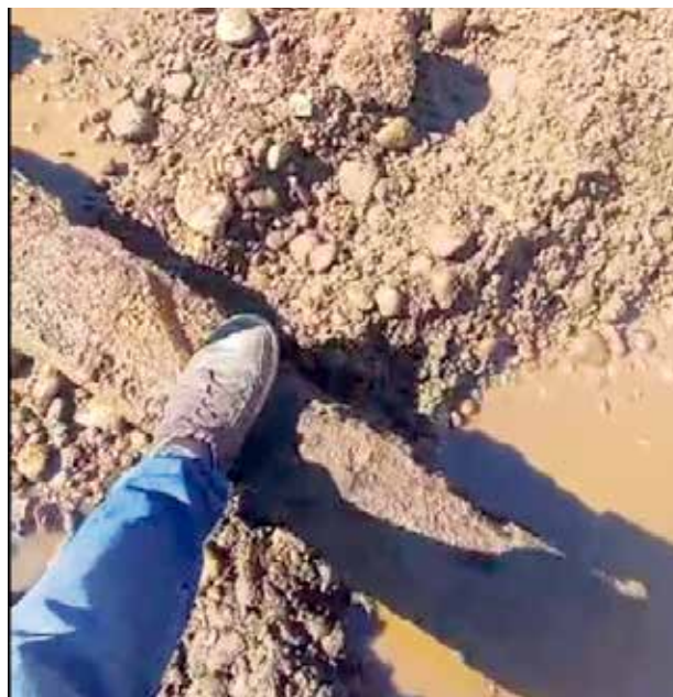
На фото — кусок балки с огромным гвоздем, который вытащили специалисты «Водоканала», когда на глубине шести метров под землей прокладывали сети КНС микротоннельным комплексом. Как считает главный инженер подрядной организации Антон Калашников, очевидно, это часть очень старых коммуникаций, того времени, когда здесь был причал Ангары. Если такие металлические предметы попадают в сепарацию проходческого щита, оборудование выходит из строя. Возникающие проблемы решают не менее чем в трехдневный срок, а чтобы скорректировать отставание, работают круглосуточно
