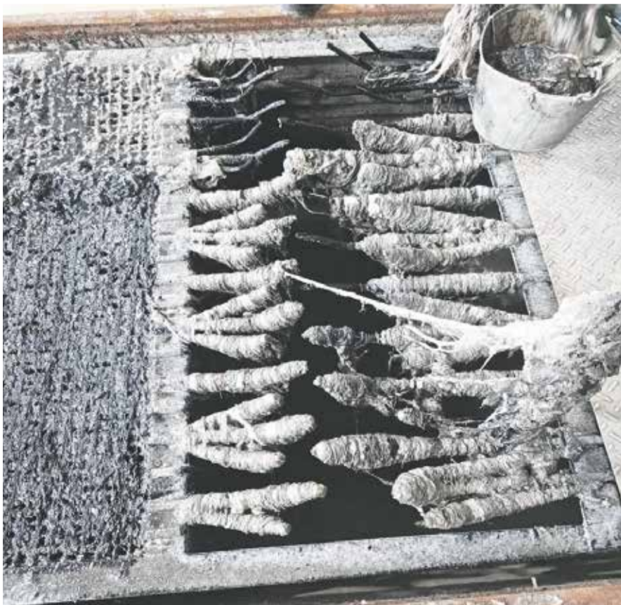
«Зубы дракона» — так на канализационных очистных сооружениях называют этот фильтр, отсеивающий крупный мусор. А что касается мелкого, то главная проблема — это популярные сегодня у горожан влажные салфетки. Именно они нещадно забивают решетки, наматываются на арматурки (результат — на фото). И работникам комплекса приходится постоянно вручную (!) чистить фильтрующие решетки. Через нашу газету сотрудники КОС правого берега просят иркутян утилизировать эти салфетки в мусорные ведра, а не в канализацию
