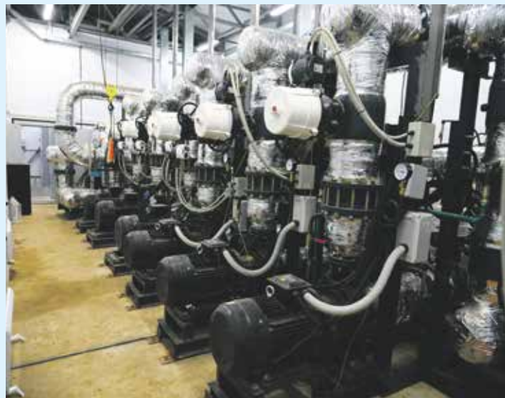
Современная тепловая насосная станция «Лисиха-2», возведенная в рамках проекта «Тепловой луч», позволяет перекачать 7,5 тысячи кубометров горячей воды в час. Причем она полностью автоматизирована, все параметры передаются на главный щит управления Ново-Иркутской ТЭЦ, в работе объекта не задействован ни один человек!
