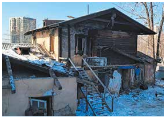
Так выглядела усадьба Кудельского до начала реставрации: стены в сквозных трещинах, под наклоном, разрушена кладка. Причины плачевного состояния дома много — холодный и влажный сибирский климат, просадочные грунты и несколько пожаров, которые пережило здание в прошлом веке
